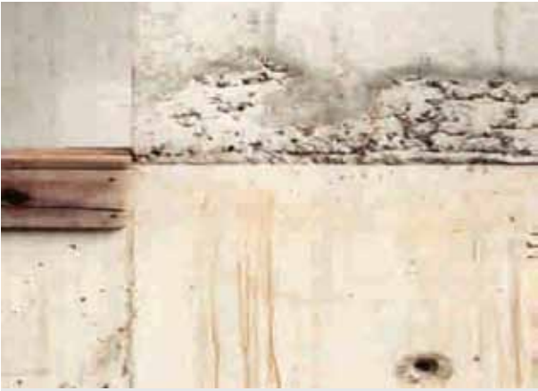
Sıva Kusurlarıyla dolgu gerektiren yeni beton
