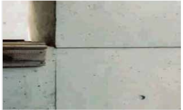
KEIM Concretal-Feinspachtel ile segregasyonlu alanların onarımı ve mineral renk eşleşme yoluyla düzeltilen yüzeyler
