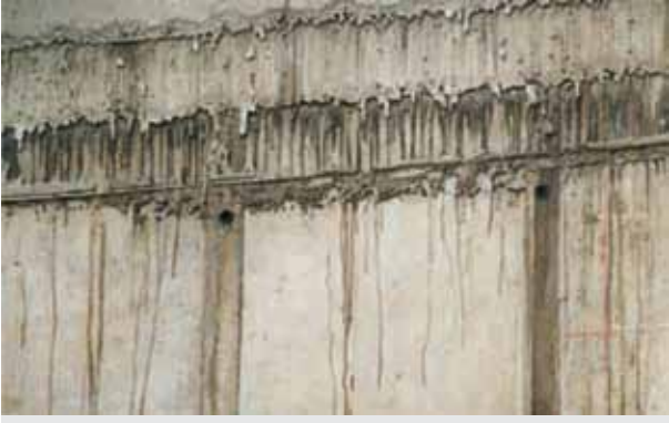
Sıva Kusurlarıyla dolgu gerektiren yeni beton
